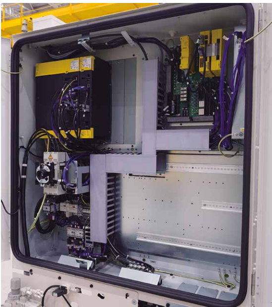
制御盤内の様子
