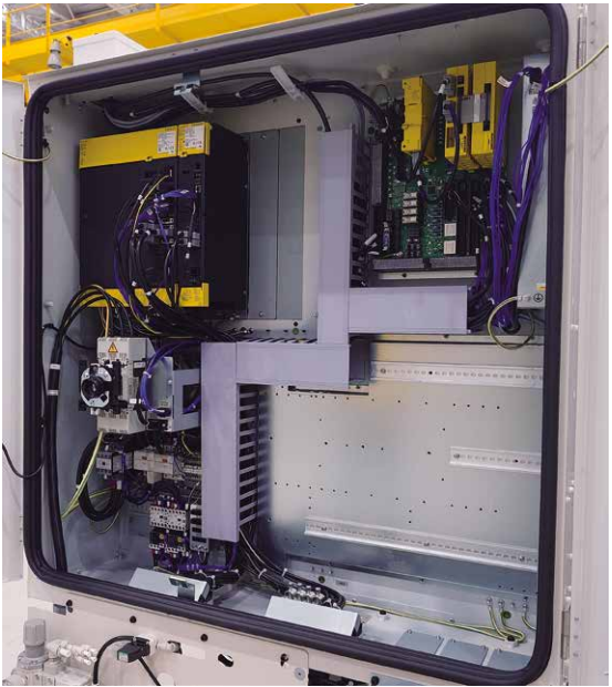
制御盤内の様子
