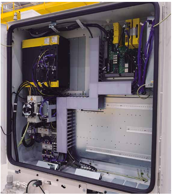
制御盤内の様子
