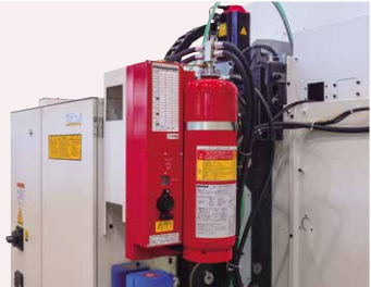
自動消火装置
